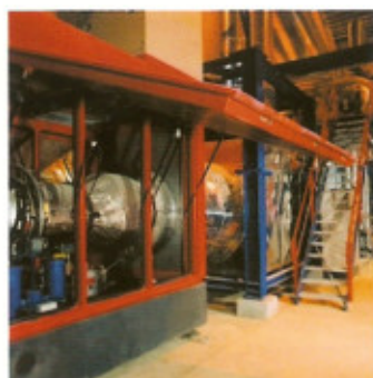
Figura 2: Turbina a gás e caldeira de recuperação
